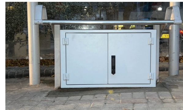
«Bus stop» cabinets
