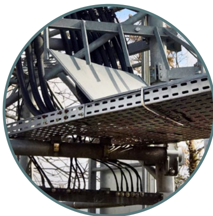
Chemin de câble
