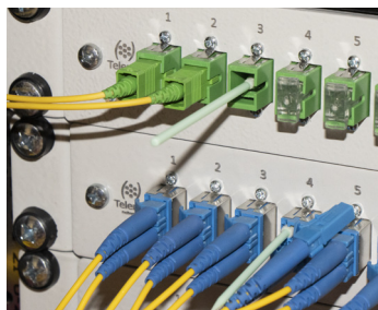
Nettoyage d'un raccord SC/ST
